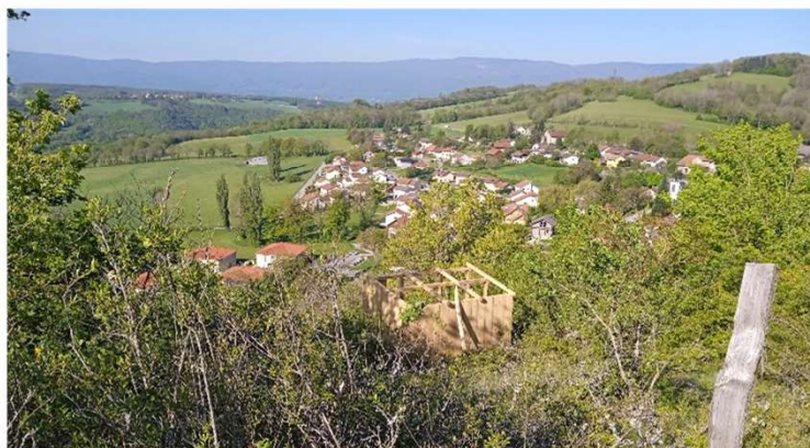
Cabane des chèvres en cours de construction Action menée avec la CAPG, le Conservatoire des Espaces Naturels et un habitant
