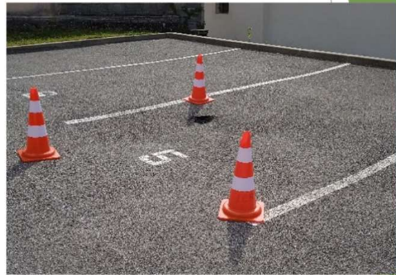
20/04/2022 effondrement du parking de la place de Grésin : Appel à témoins quelqu'un aurait vu quelque chose ?
